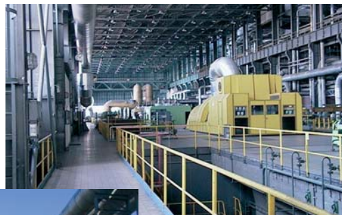
Strojovna / Turbine Hall
